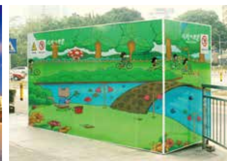
深圳供电局环网柜改造 融入城市环境 宣传节能理念 ▲
