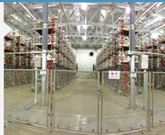
多端柔性直流输电系统换流阀 ▲
